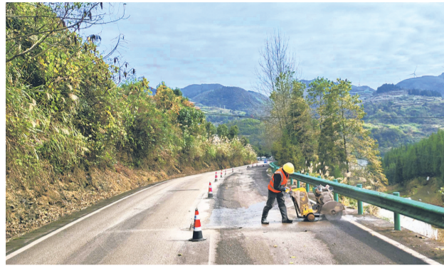
规范切割S308线路面病害
